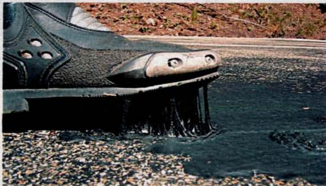
Zähflüssiges Bitumen: Wenn nicht genügend Geld für eine gründliche Reparatur da ist, flicken die Kommunen die Schäden einfach notdürftig
