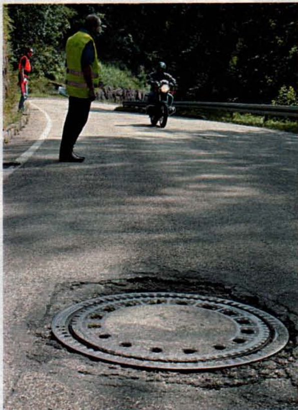
Gefahr vor allem für Motorradfahrer: ein tiefer liegender Schachtdeckel auf der L 343 zwischen Bad Liebenzell und Schömberg
